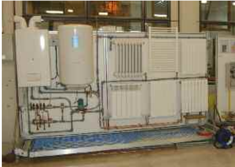
Instalación de calefacción y ACS.
