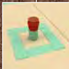
Penetración de tuberías
