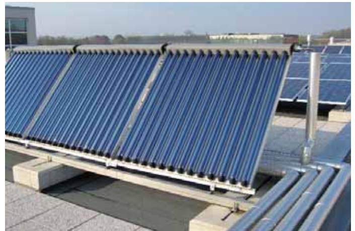
Paneles de tubos de vacío
