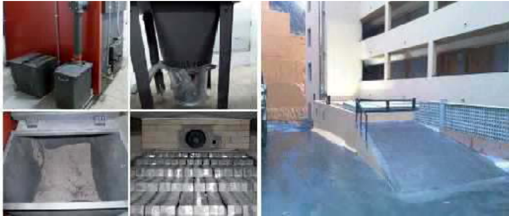
Figura 4: Detalle de distintos elementos de la caldera de biomasa (izquierda) y rampa de descarga a silo (derecha).
