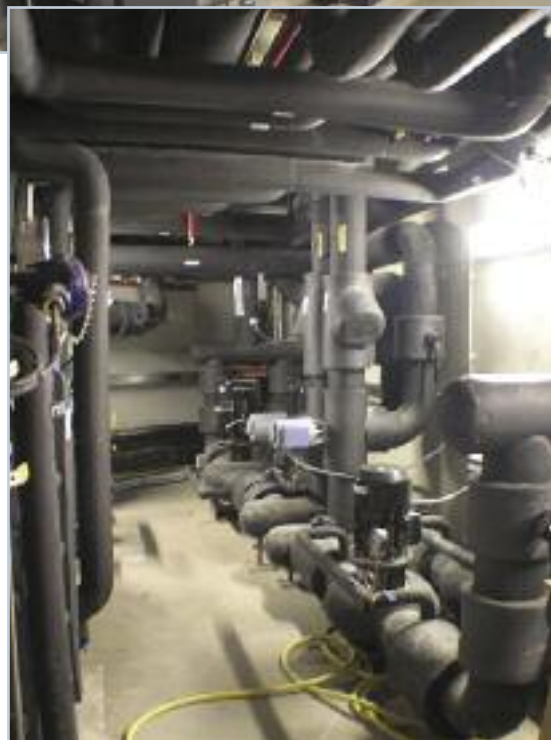
Sala de intercambiadores y bombas de agua caliente
