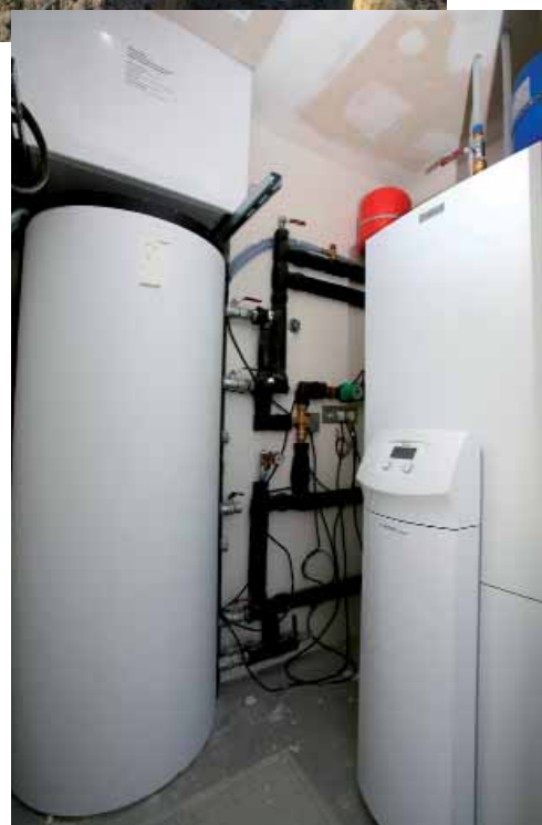
Bomba de calor geotérmica junto al acumulador multi-energía y el sistema de ventilación mecánica controlada
