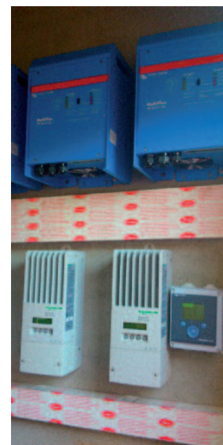
Inversores de corriente
