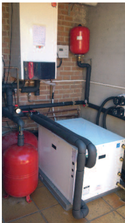
Detalle de la sala técnica
