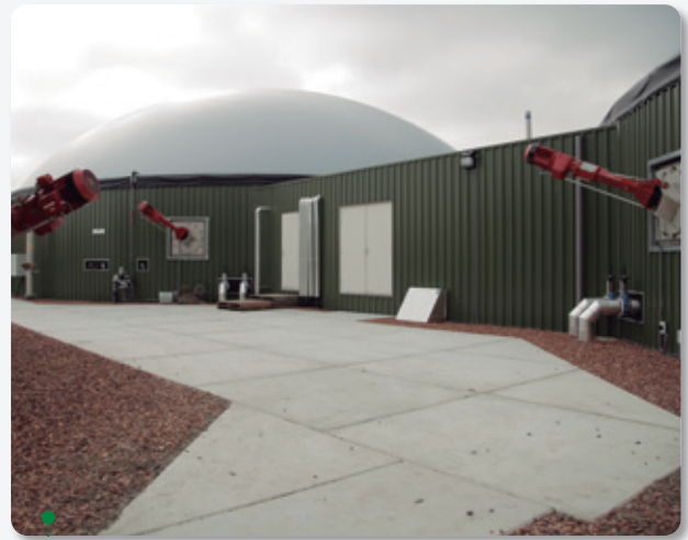
Planta de biogás Hensbroek (Holanda). Fuente Biovic Hensbroek biogas plant (The Netherlands). Source: Biovic
