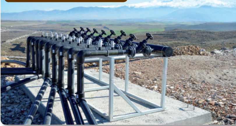
Ilustración 2. Estación de regulación y medición (ERM) Image 2. Regulation and metering station
