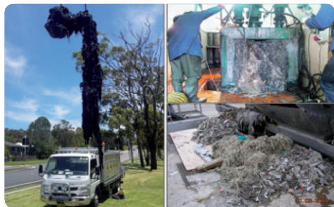
Figura 1: Diversos problemas generados por toallitas y textiles en saneamientos. Izqda., acumulación de más de 5 m en redes; dcha. arriba, tamiz en bombeo; dcha. abajo, entrada EDAR. | Figure 1: Diverse problems caused by wipes and textiles in sewer systems. Left, accumulation of over 5 m in networks; above right, Pumping station screen; below right, WWTP inlet.
