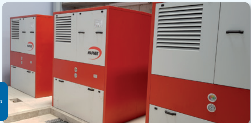
Modelo SEM11,8 Trilobular (Roots) para la aplicación de los desarenadores, tres equipos debidamente anclados y con su bancada de hormigón. | SEM11,8 three-lobe roots blowers for the degritters. The three units are duly anchored on concrete mounts.
