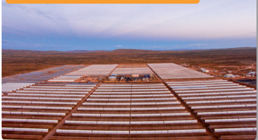
Planta termosolar Bokpoort (Sudáfrica). Foto cortesía de SENER Ingeniería y Sistemas Bokpoort CSP plant (South Africa). Photo courtesy of SENER Ingeniería y Sistemas
