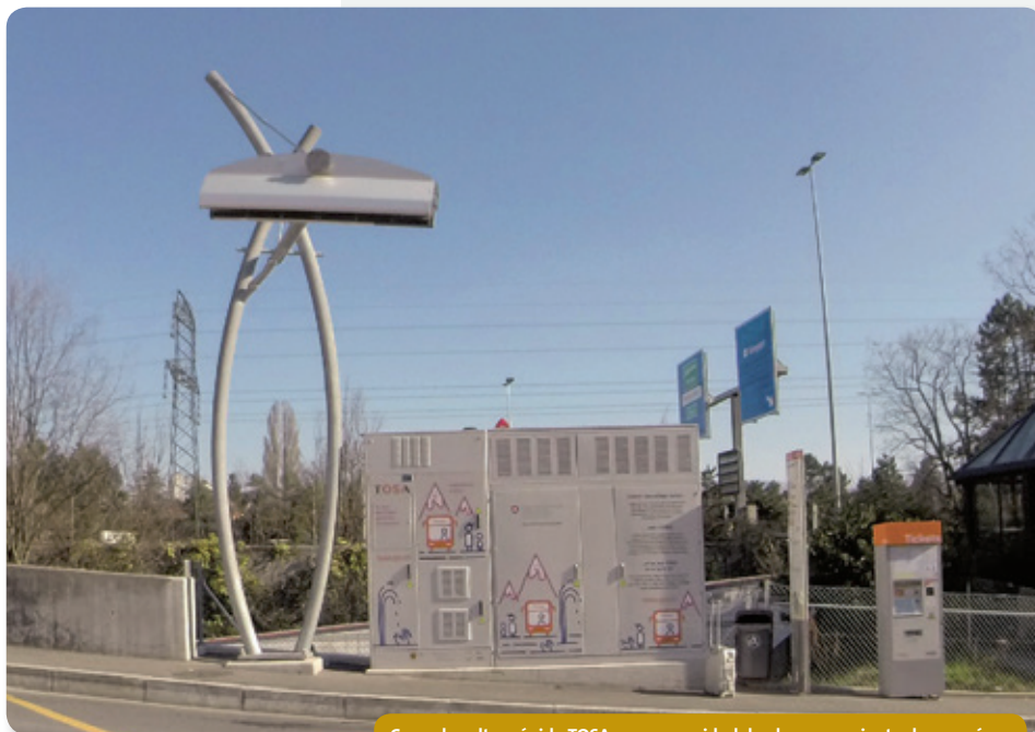
Cargador ultrarrápido TOSA con una unidad de almacenamiento de energía en Ginebra. La línea de Nantes no necesita energía almacenada en las paradas de autobús. | A TOSA flash charger with an energy storage unit in Geneva. The Nantes line does not require stored energy at bus stops.
