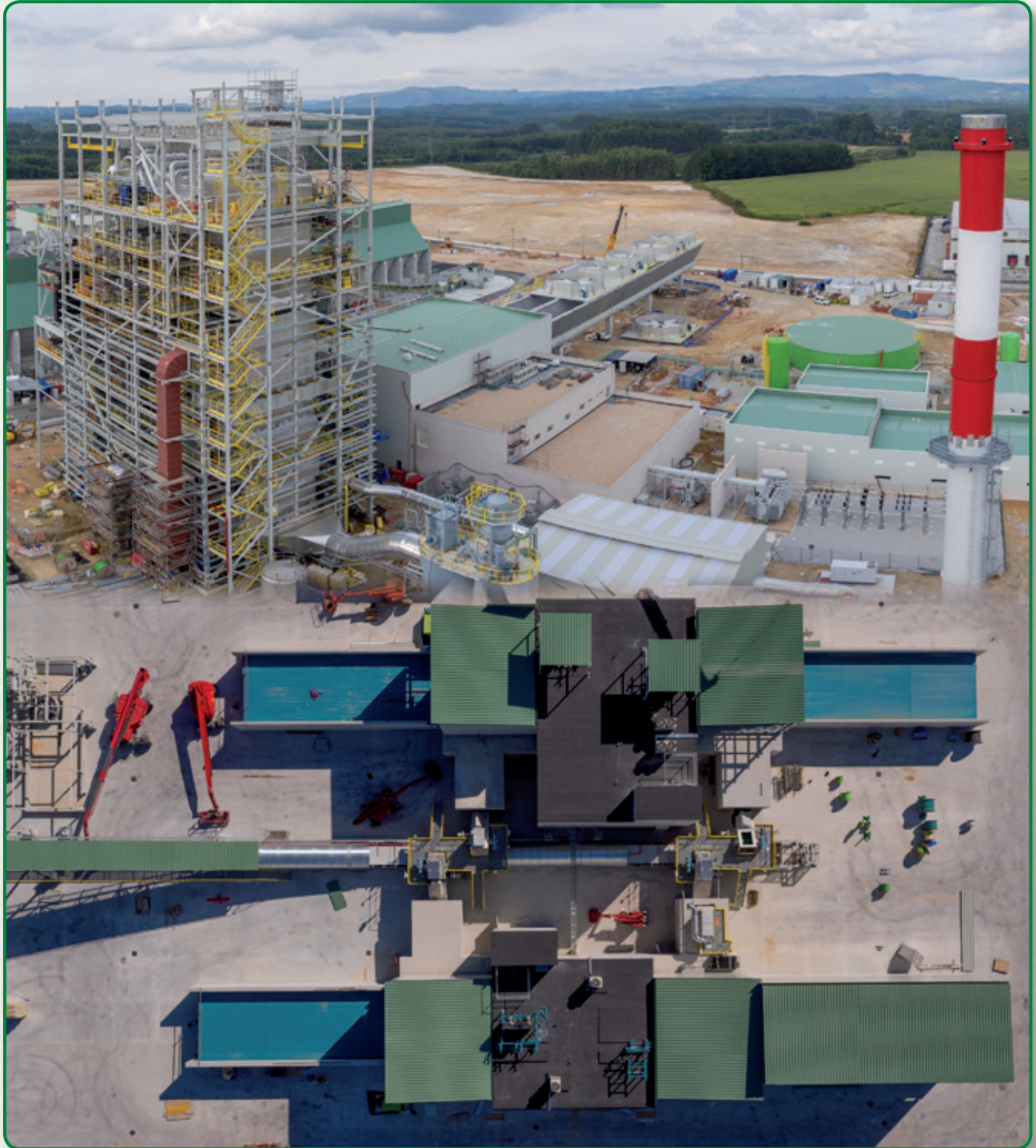
Planta de biomasa de Curtis-Teixeiro (A Coruña, Galicia, España) Curtis-Teixeiro Biomass Plant (A Coruña, Galicia, Spain)
