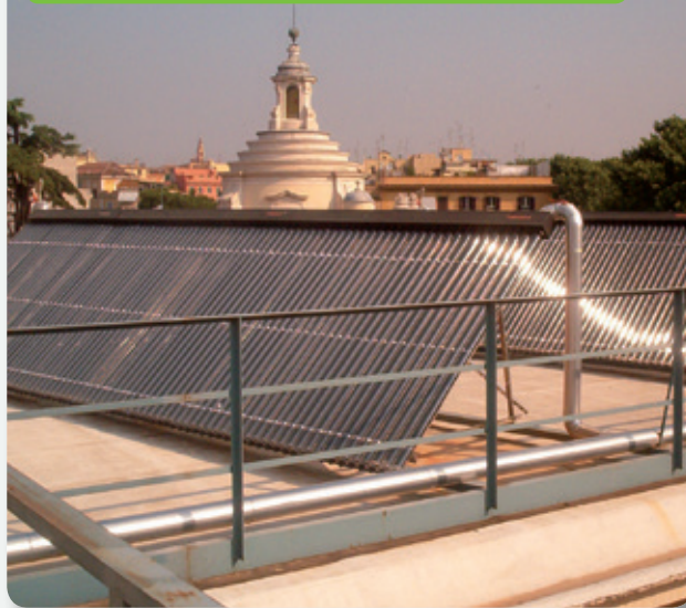
Colectores solares térmicos en un hospital en Roma. Foto cortesía de la Plataforma Tecnológica Europea de Calefacción y Refrigeración Renovable/ Thermomax | Solar thermal collectors in a hospital in Rome. Photo courtesy of the European Technology Platform on Renewable Heating & Cooling/Thermomax
