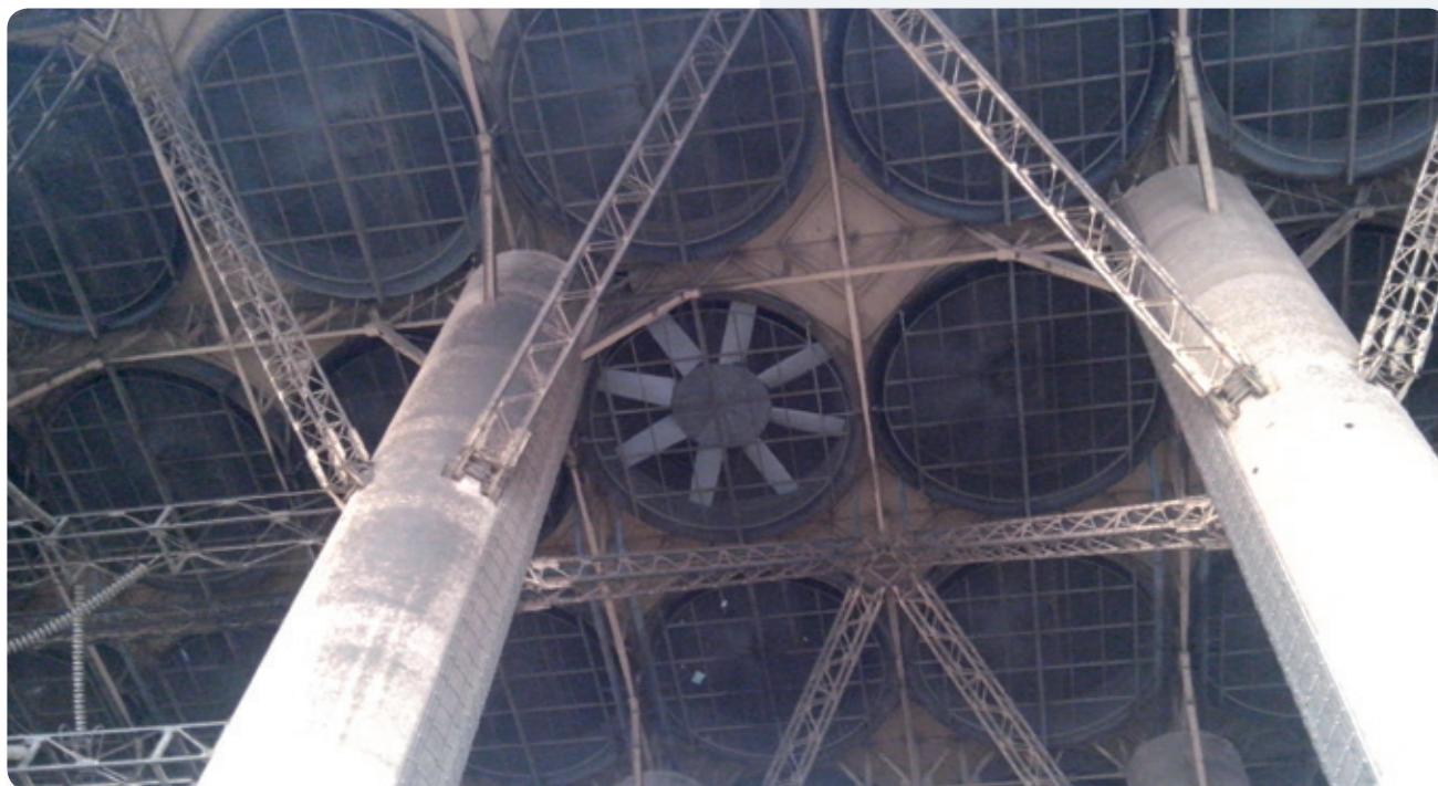
Instalación del ventilador en Matimba. Foto cortesía de Notus Fan Engineering | Fan installation at Matimba. Photo courtesy of Notus Fan Engineering
