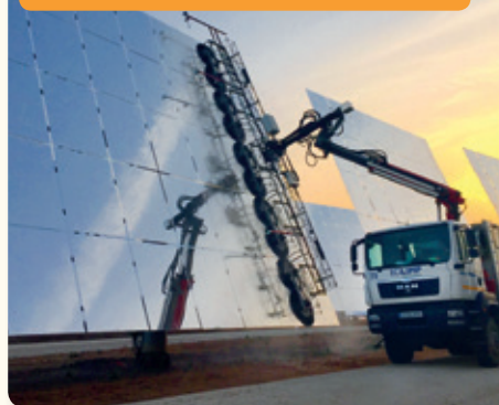
Planta Gemasolar, propiedad de Torresol Energy – Sener®. Tecnología de limpieza propiedad de Ecilimp Gemasolar plant, owned by Torresol Energy - Sener®. Cleaning technology owned by Ecilimp
