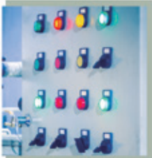
Distrib. Energía & Media Tensión
