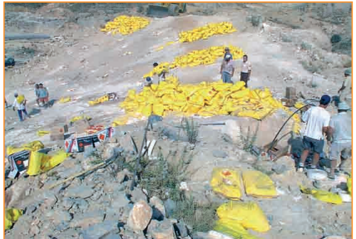
[Figura 3].- Preparación de una voladura de desmonte con 43 t.de explosivos en Macael.
