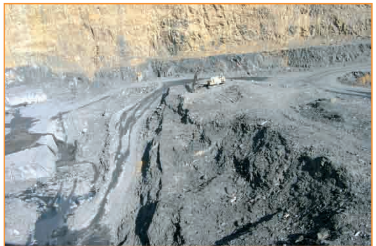
[Figura 4].- Perforación para voladura de desmonte de capa de Pizarra en Mahide (Zamora).
