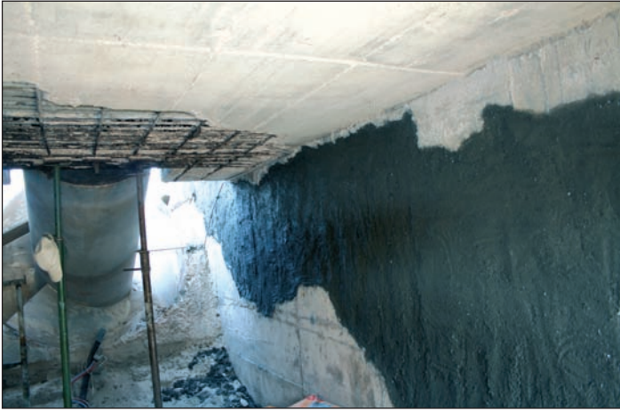
■ El deterioro del hormigón llega en ocasiones a afectar a la armadura de acero.
