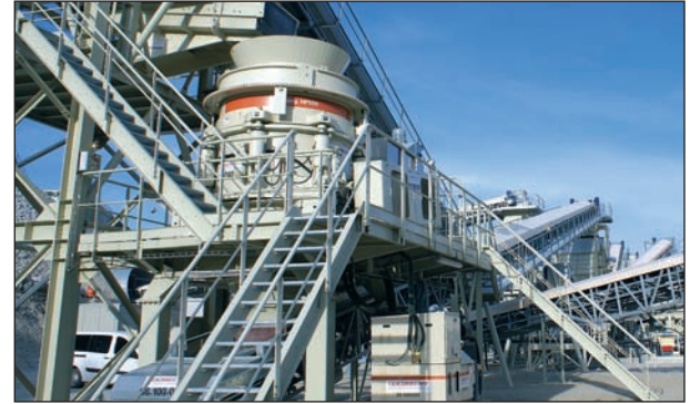
Vista del puesto primario de la planta.
