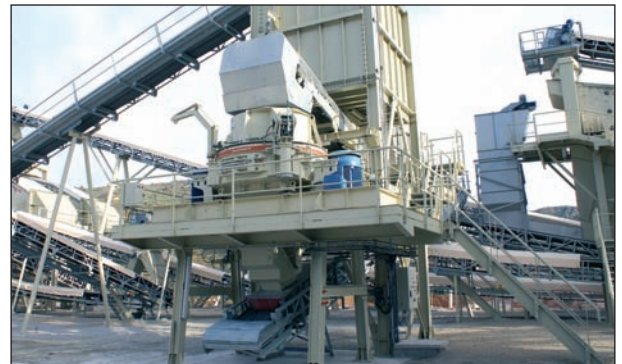
Vista de los dos trituradores de cono terciarios HP300.
