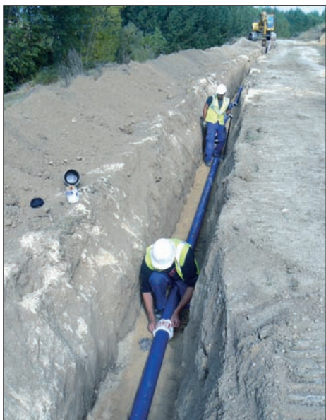
Los operarios proceden al empalme de las tuberías en el interior de la zanja.
