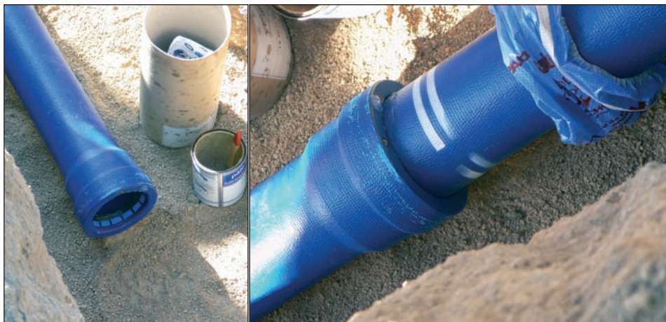
Detalle de la brida de terminación de la tubería y bote de cola para el encaje de la tubería siguiente.
