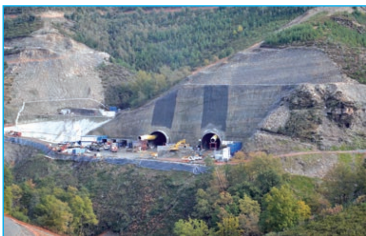
Vista de la explanada para aparcamiento y mantenimiento de equipos y frente con las dos bocas de los túneles excavadas.
