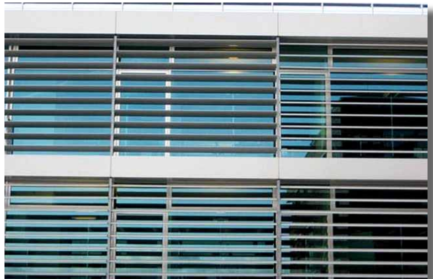
▲ Figura 7 - Protecciones solares exteriores
