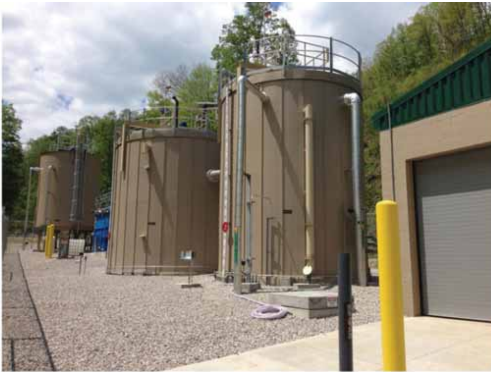
Figura 3. Imagen de la EDAR instalada en la Planta 1 en una de las minas de carbón de Estados Unidos. De derecha a izquierda, los principales equipos de la EDAR: 1ª MBBR de desnitrificación, 2ª etapa MBBR para reducción de selenio, Actiflo® (color azul) y espesador de fangos provenientes del Actiflo®.
