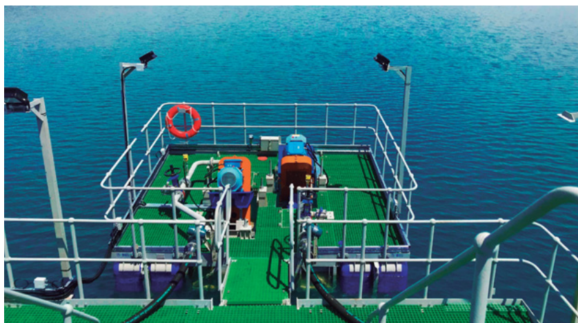
Bombas Warman DWU montadas en barcasas de pontones Multiflo AC de polietileno.
