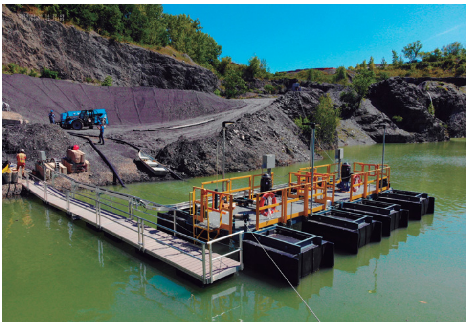
Bombas Floway VTP montadas en barcazas de pontones Multiflo EC de polietileno.
