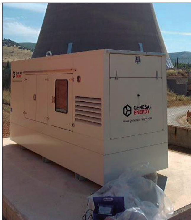
Instalación del sismógrafo en la subestación eléctrica de REE a 105 metros de la torre
