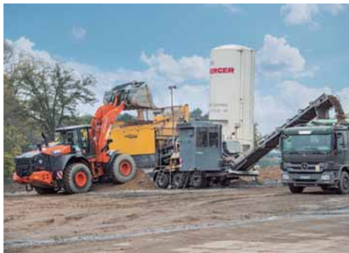
Gracias al dosificador de dos compartimentos y de grandes dimensiones, la mezcladora móvil KMA 220 de Wirtgen es capaz de cargar dos tipos diferentes de material de roca. Sin embargo, en la obra del aeropuerto de Colonia/Bonn la mezcladora se cargó solo con una mezcla de minerales.
