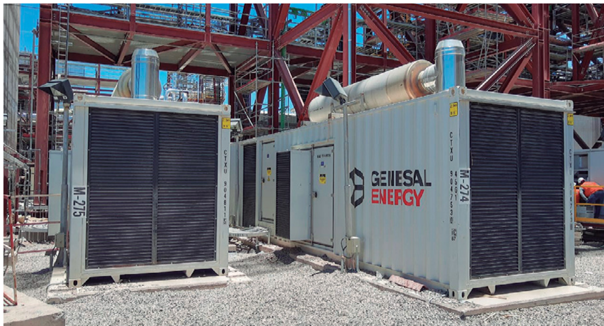
Grupos electrógenos Genesal Energy instalados en Cerro Dominador.
