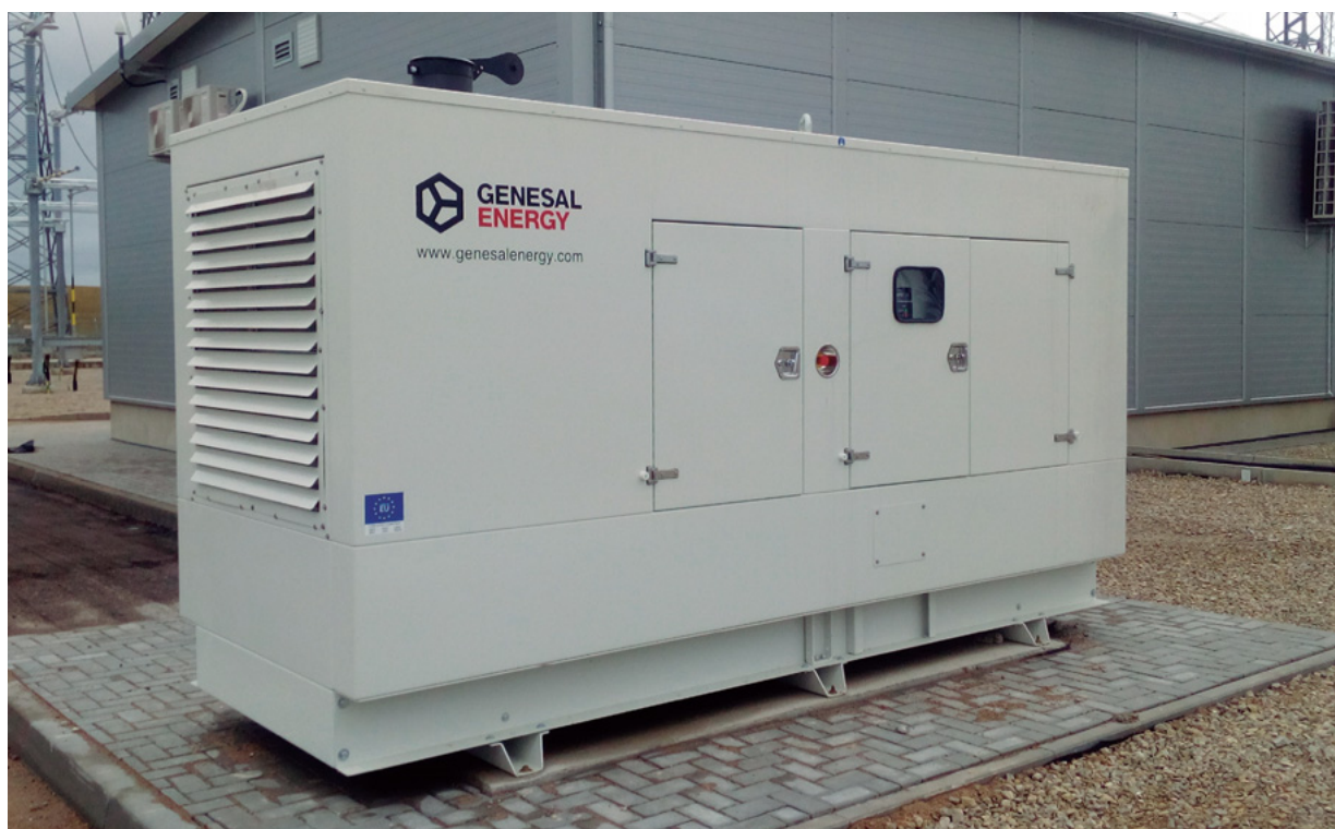
Grupo electrógeno Genesal Energy instalado en la subestación eléctrica.
